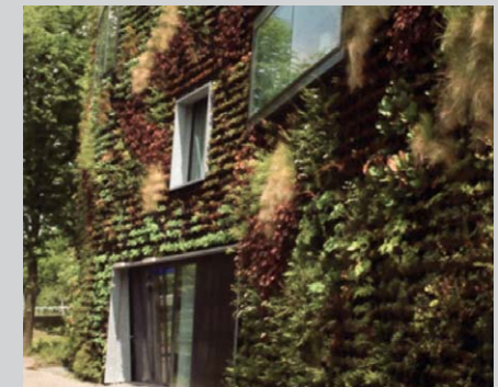
Uso del muro verde per aumentare l'isolamento delle pareti
